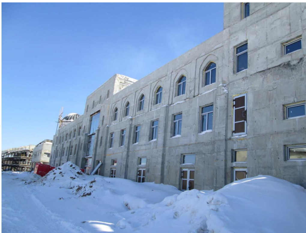
Рис. 1. Применение монолитной технологии на примере КОТЦ «Этномир». Построено 2 здания общей площади 7000 м 2 , за период с 8 августа по 15 декабря 2012 г. с применением установки Сармат-Горнадо МС-500 силами шести-семи человек.
