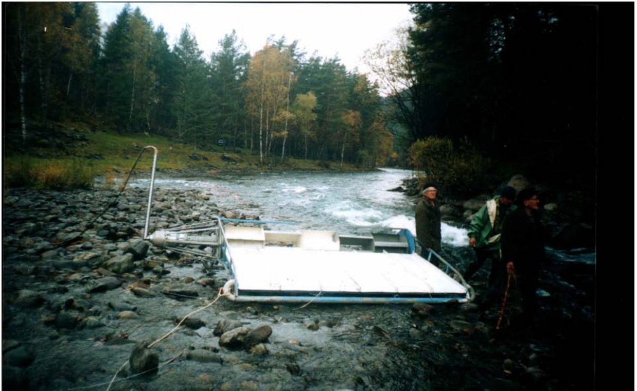
Фото 3. Микро-ГЭС 1,5 кВт перед установкой в поток.
