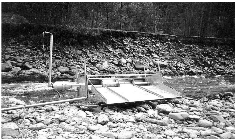
Фото 1. Микро-ГЭС 0,35 кВт перед установкой в поток.
