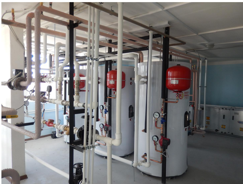
Рис. 6. Общий вид компоновки теплообменников системы ГВС
