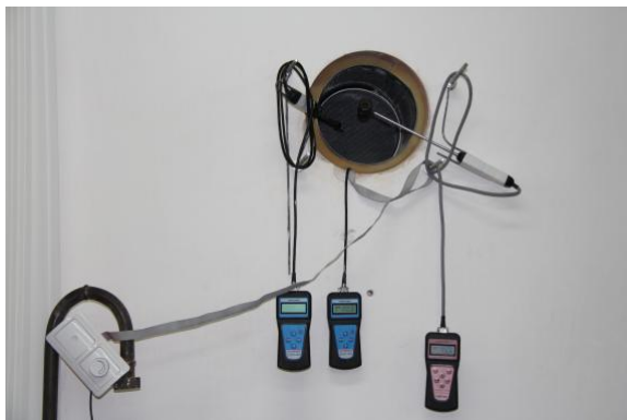
Рис. 4. «УВРК-50», установленный для проведения испытаний (вид из помещения)
