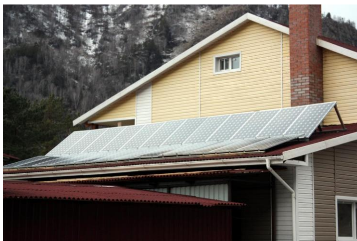
Рис. 4. Размещение солнечных модулей на крыше котельной.
