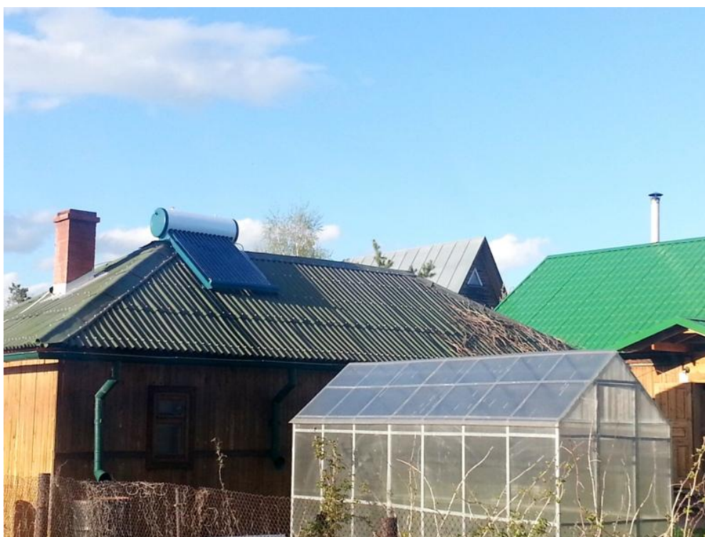
Рис. 12. Нагрев воды солнечным коллектором в частном доме, г. Новосибирск.
