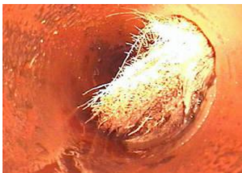
Рис. 5. Заросший корнями канализационный сток [9].
