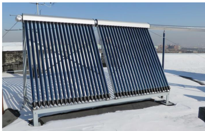
Рис. 17. Солнечные коллекторы для генерации тепловой энергии.
