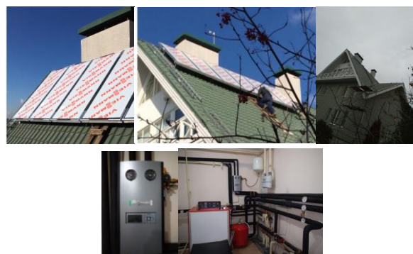
Рис.2. Элементы системы энергоснабжения коттеджа с использованием системой 6 солнечных батарей GPSolar и 6 солнечных коллекторов Viessmann Vitosol 100FM.
