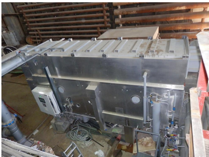
АБХМ-2000П, Астраханская ТЭЦ2, г. Астрахань, 2015 г.
