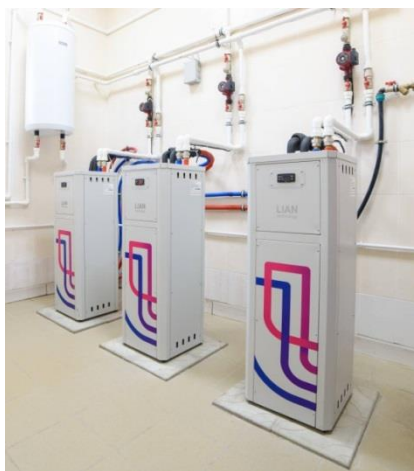
Рис. 1. Каскад геотермальных тепловых насосов.
