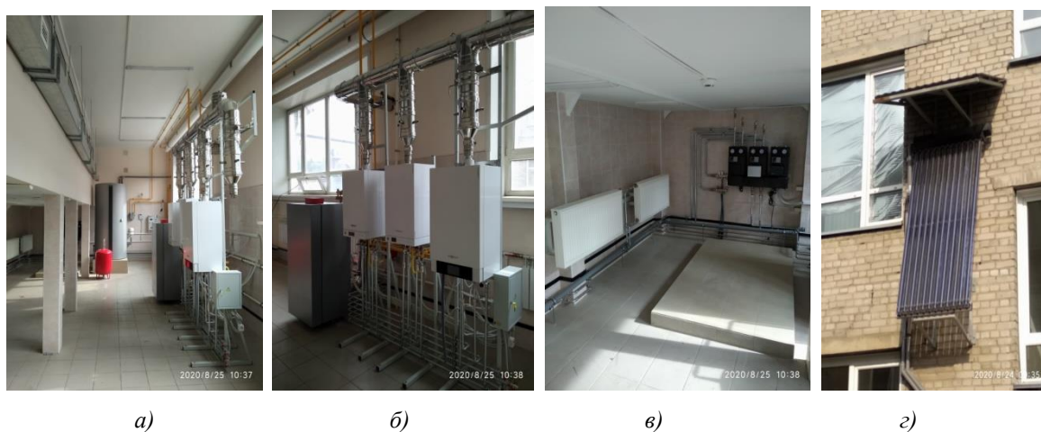
Рисунок 1. Учебный класс: а) -общий вид; б) -газовые котлы; в) -приборы систем отопления; г) -вакуумный солнечный коллектор.
